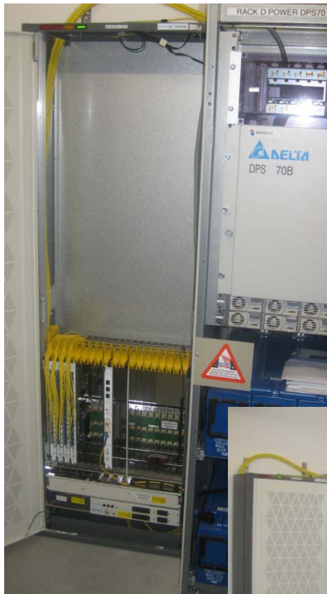
Links: SCS FAN & Stromversorgung
